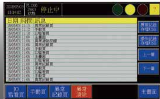
設備異常紀錄畫面
